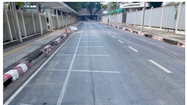
รูปที่ 2.5 ความเสียหายประเภทรอยแตกสะท้อน (บริเวณถนนระหว่างคณะครุศาสตร์กับโรงเรียนสาธิต จุฬาฯ)
